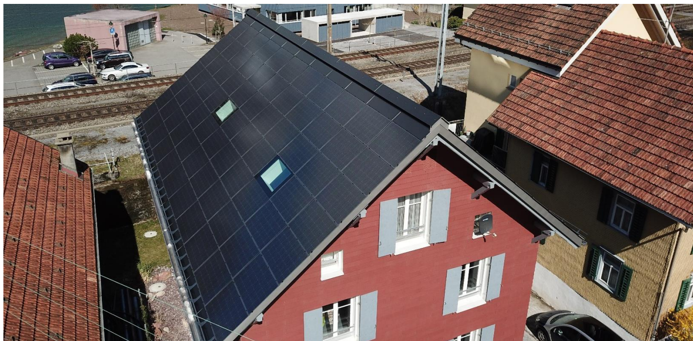
Modernisiertes Mehrfamilienhaus mit dachintegrierter Photovoltaikanlage
